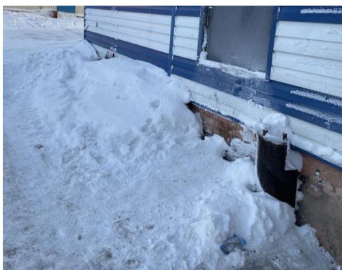
Неработающие продухи по ул. Всесвятского, 1
