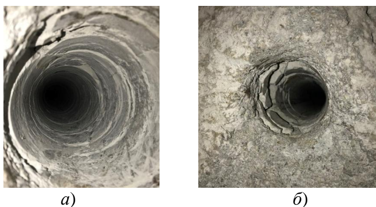
Рис. 6. Нарушения контура скважин на СЗН1 (а) и СЗН2 (б)
