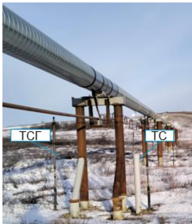
Рисунок 45. Элементы сети геотехнического мониторинга в криолитозоне на объектах нефтегазовой инфраструктуры: термометрическая скважина (ТС) и термостабилизатор грунта (ТСГ).
