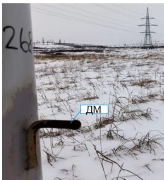
Рисунок 47. Элементы сети геотехнического мониторинга в криолитозоне на объектах нефтегазовой инфраструктуры: деформационная марка (ДМ).
