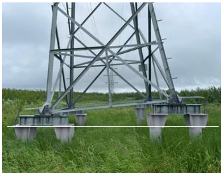
Рисунок 7. Результат морозного пучения под опорами высоковольтной линии электропередач (белая линия – горизонталь).
